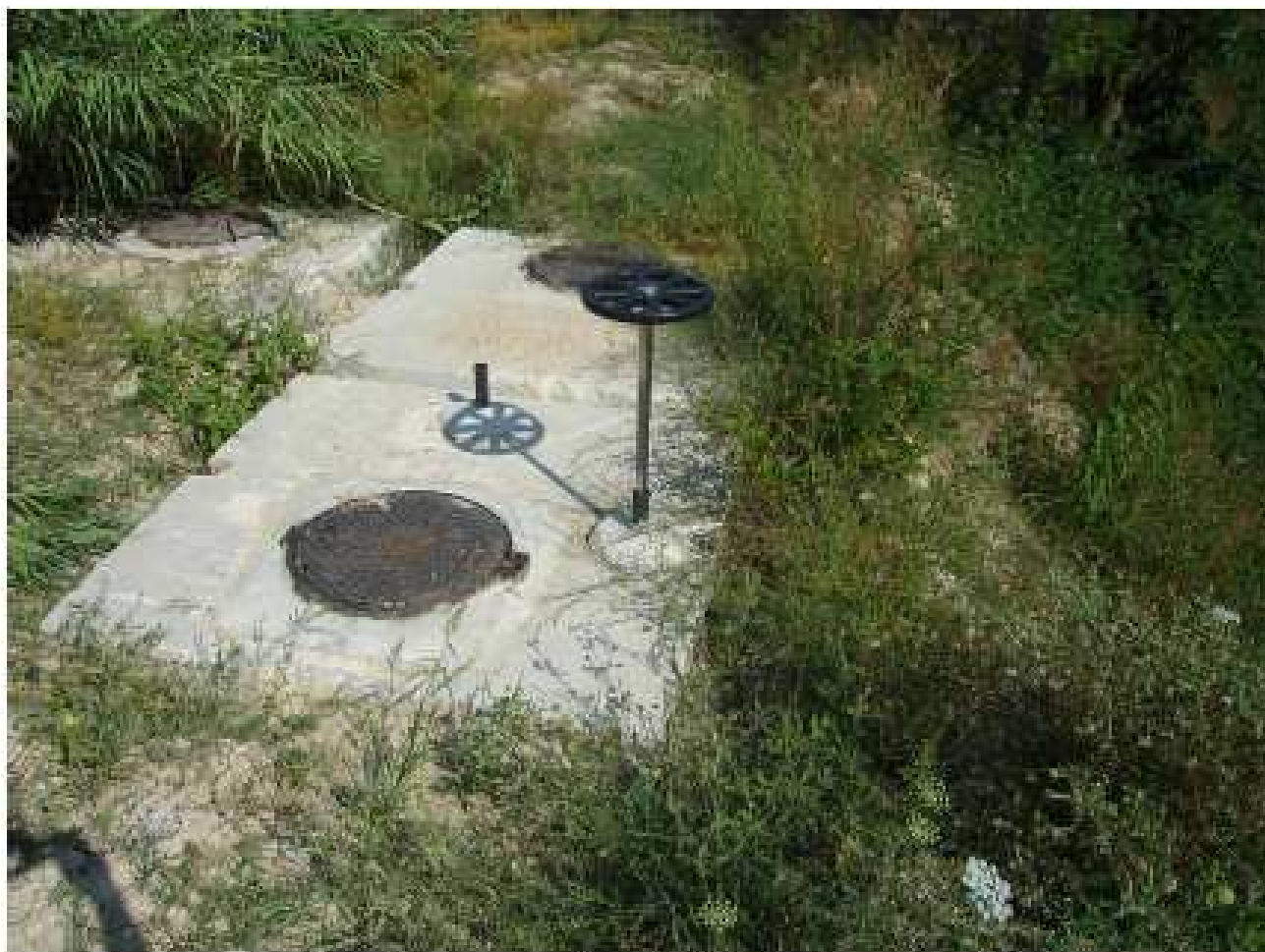
Foto10.5/2. Valvola di regolazione del flusso di acqua dalla tubazione principale
