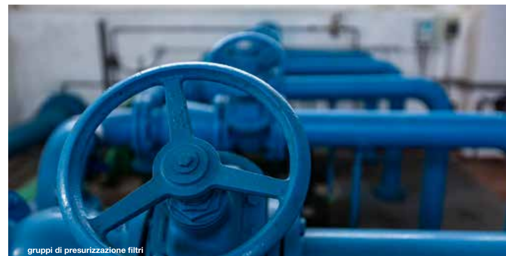
gruppi di pressurizzazione filtri
